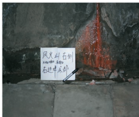
图 8 右侧墙脚部位衬砌渗水
