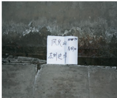
图 7 左侧墙脚部位衬砌渗水
