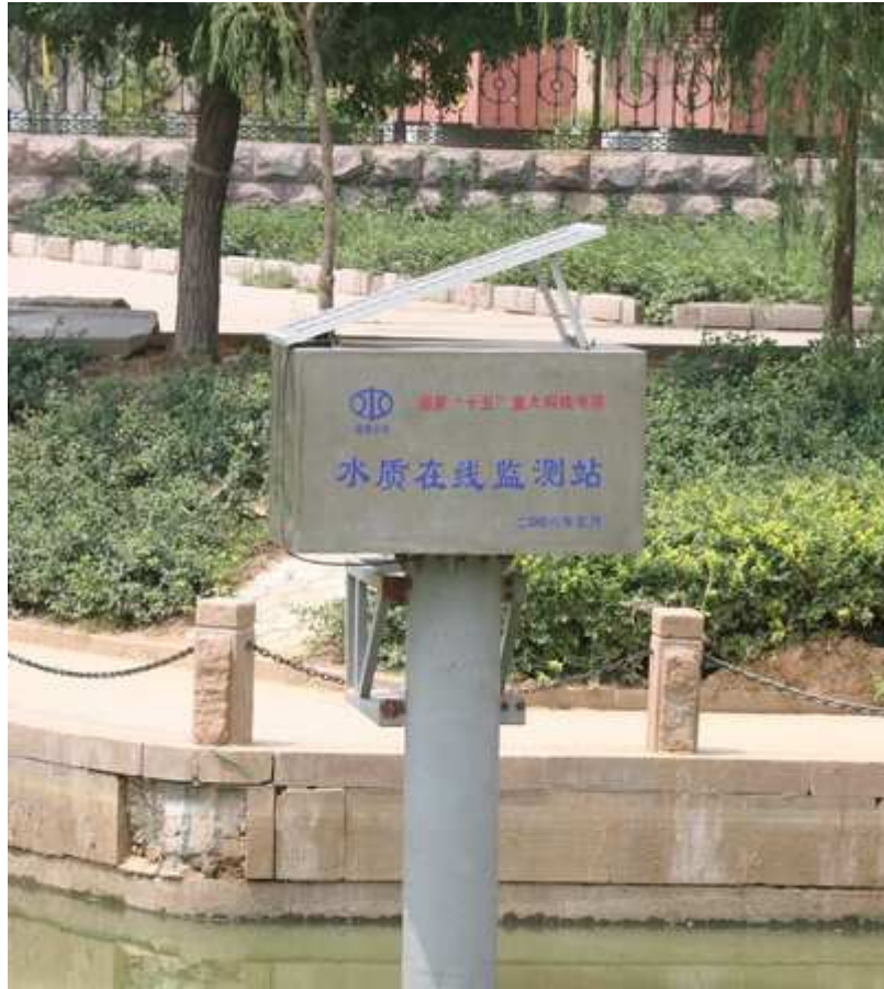
漫泗河上的在线检测中试站
