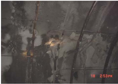
图1 共和隧道支护变形
