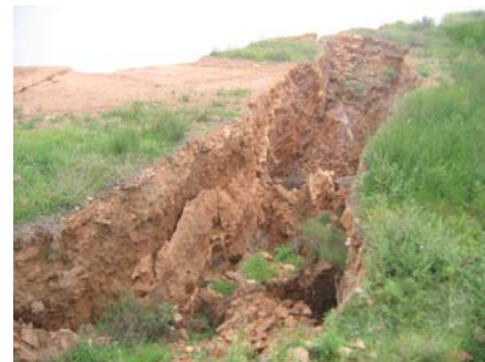
图 2 边坡顶部裂缝
