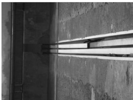
图 14 伸缩装置中型钢断裂
