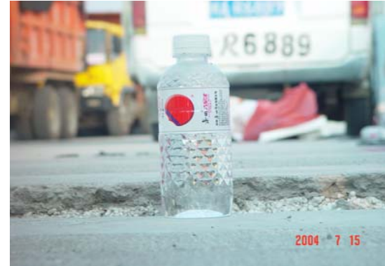
图5 0#墩内侧桥面翘起
