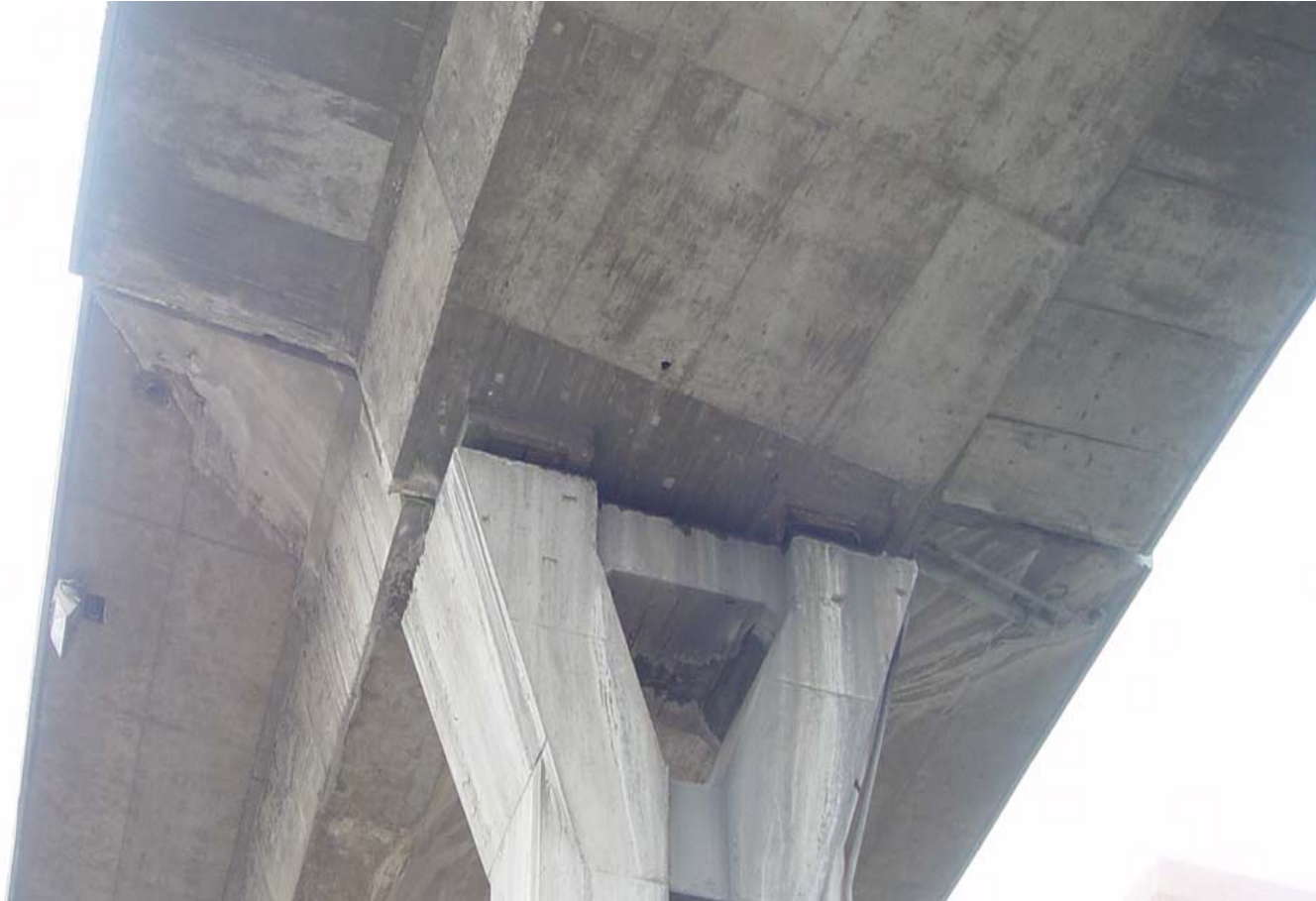
紫阳立交桥侧向位移
