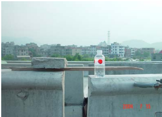
图6 0#墩内侧防撞栏翘起
