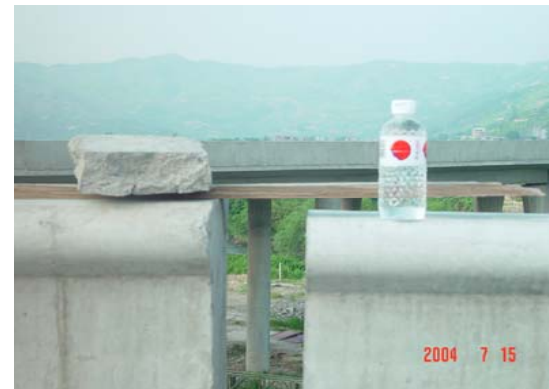
图7 0#墩外侧防撞栏下沉
