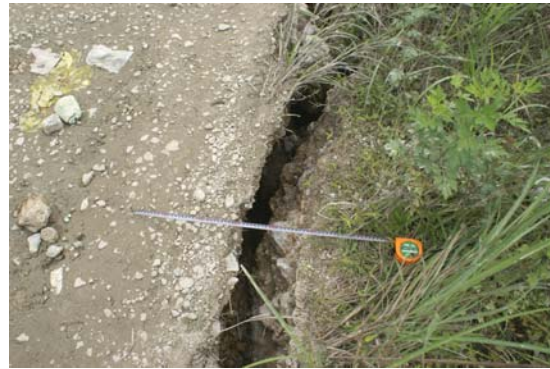
(a) 前缘高程 890 m 地表裂缝
