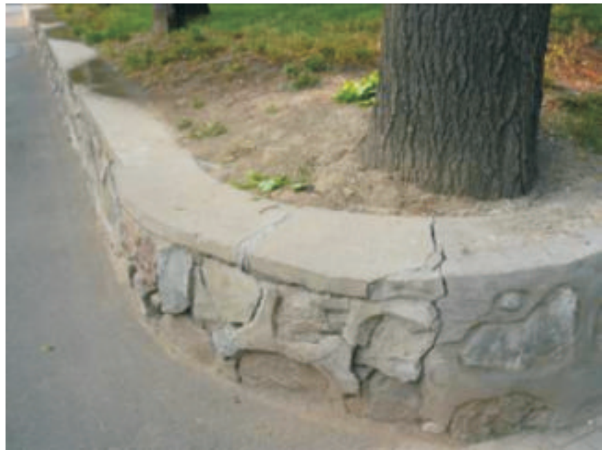
图8 植物根系破坏护坡
