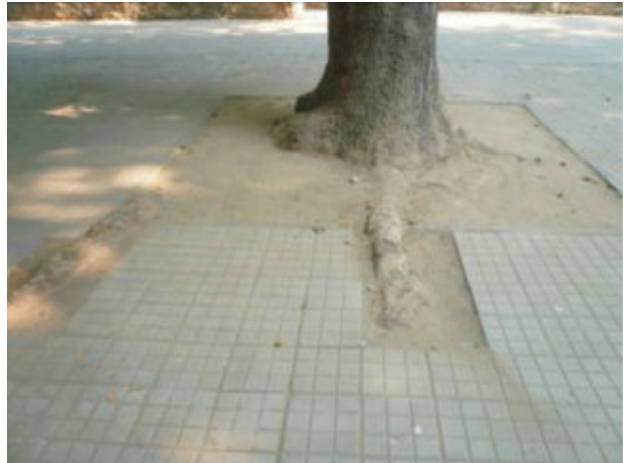
图7 植物根系破坏路面
