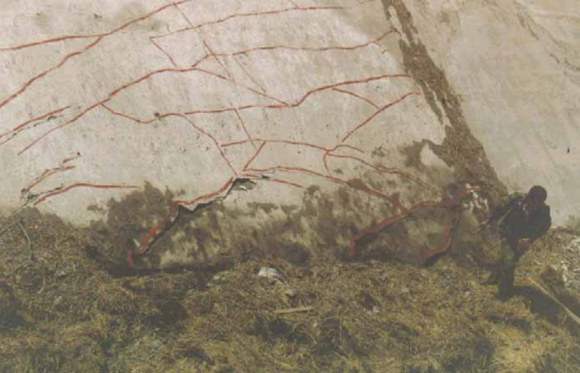
面板混凝土冻胀破坏细部情况
