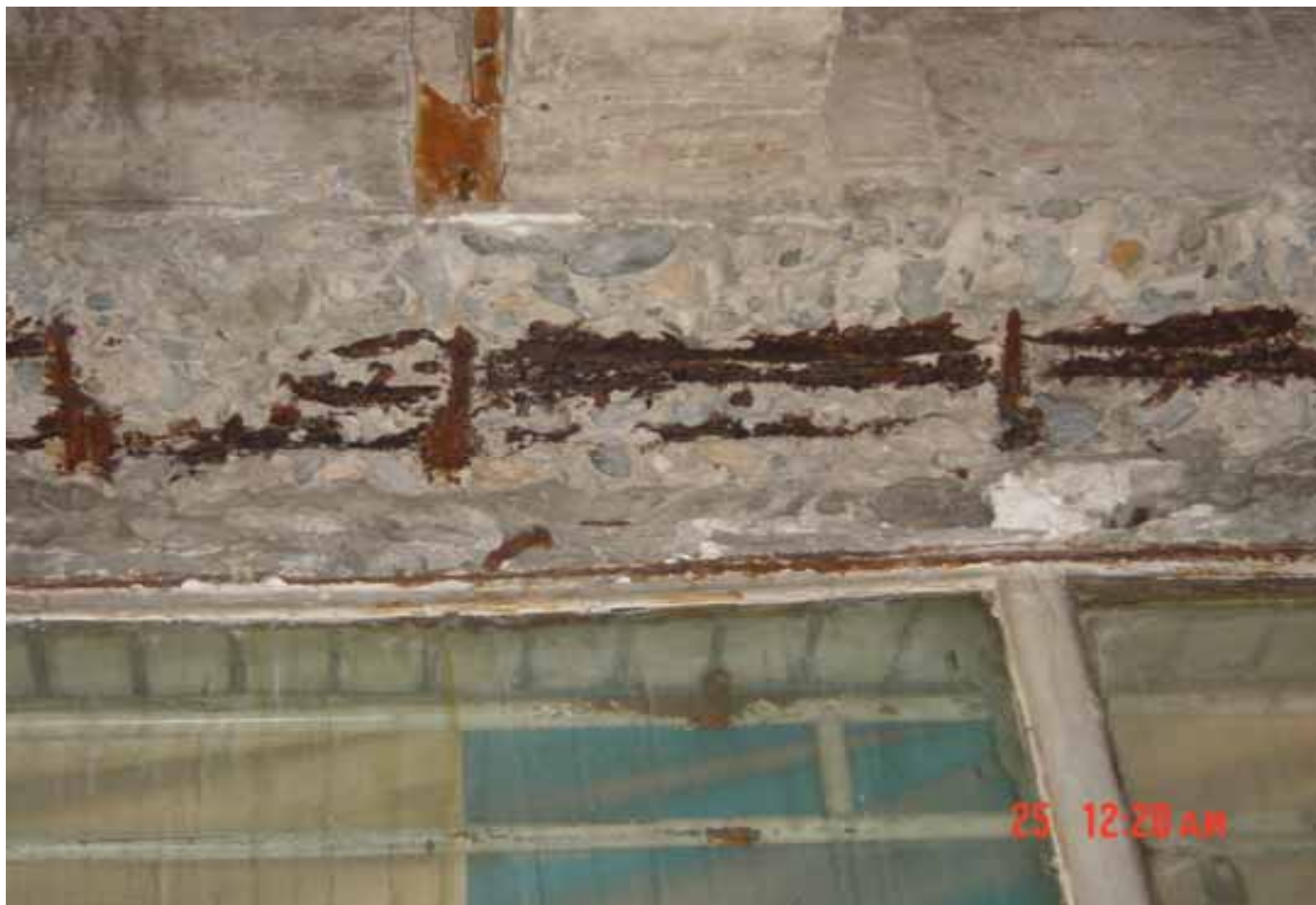
美术馆梁钢筋锈蚀情况
