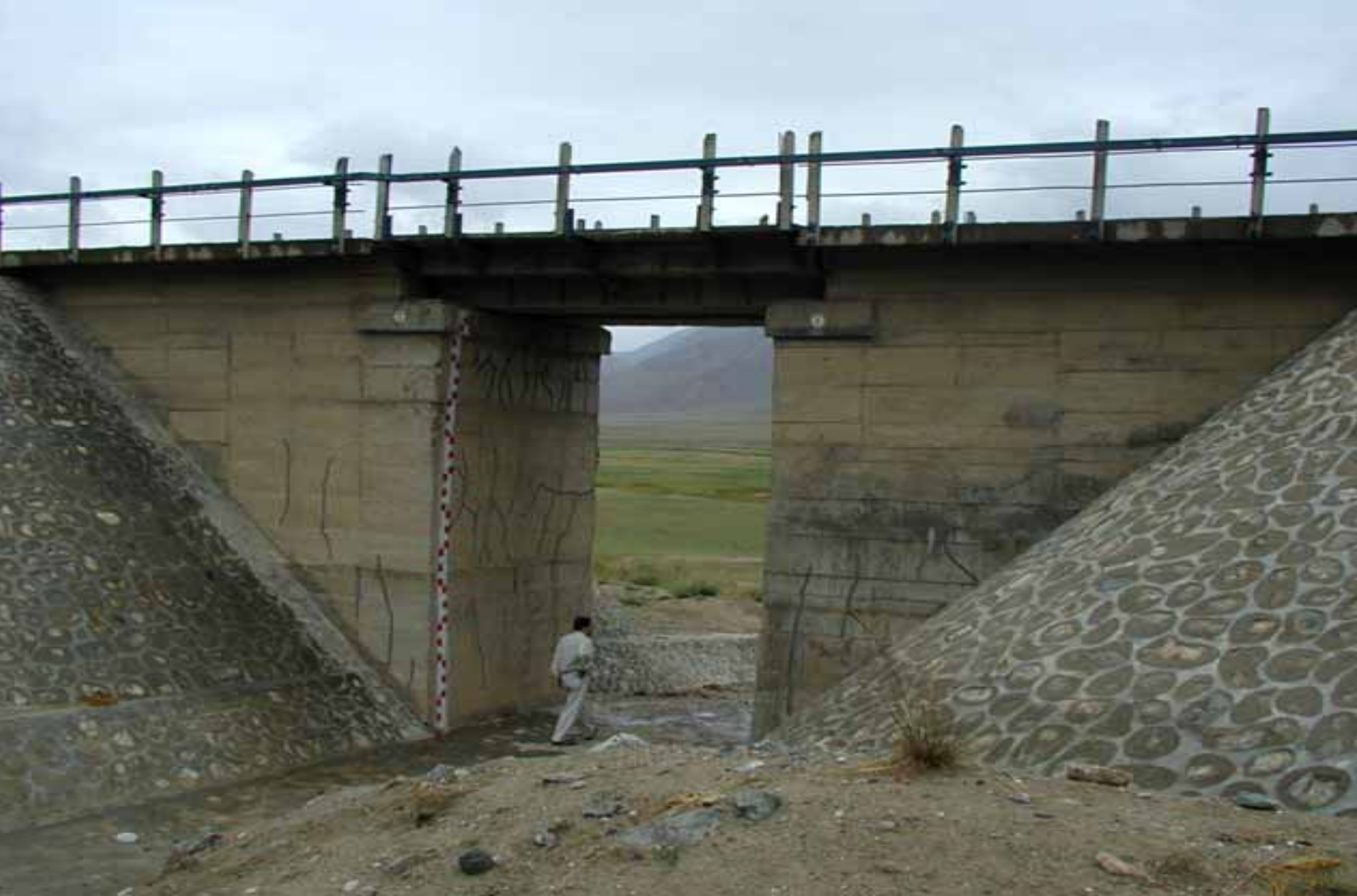
青海 - 铁路桥基座冻融破坏
