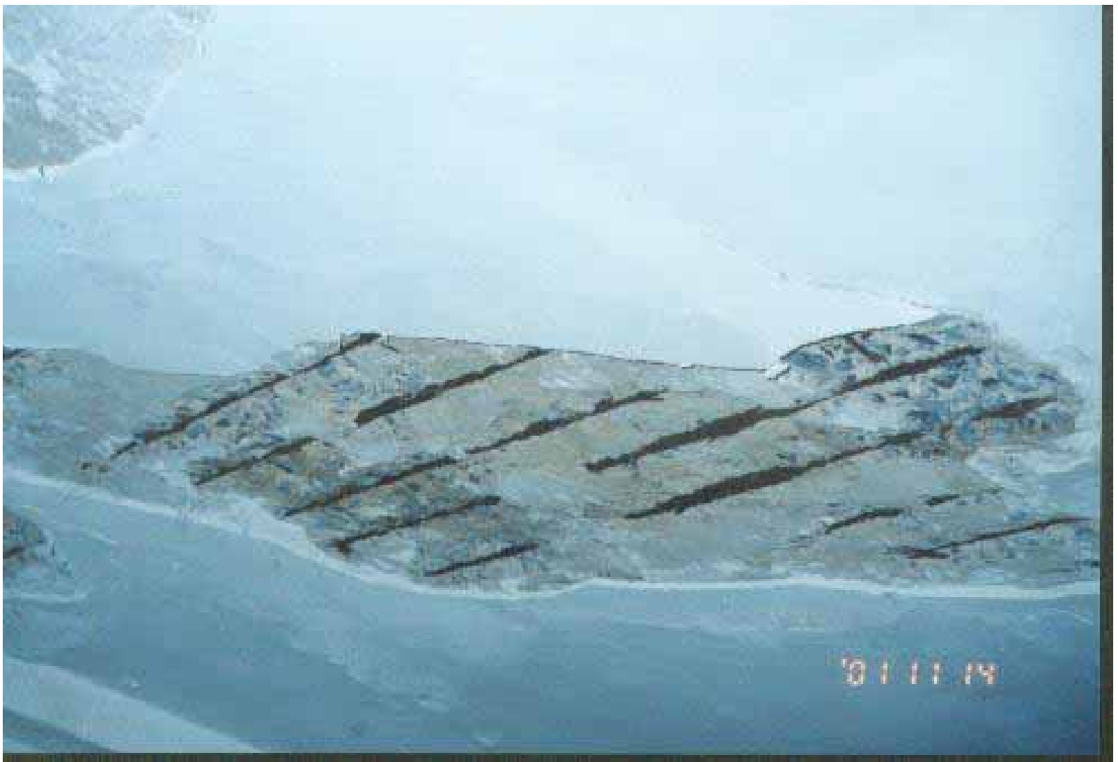
上海市政府办公楼（1935年）地下室顶板钢筋锈蚀情况
