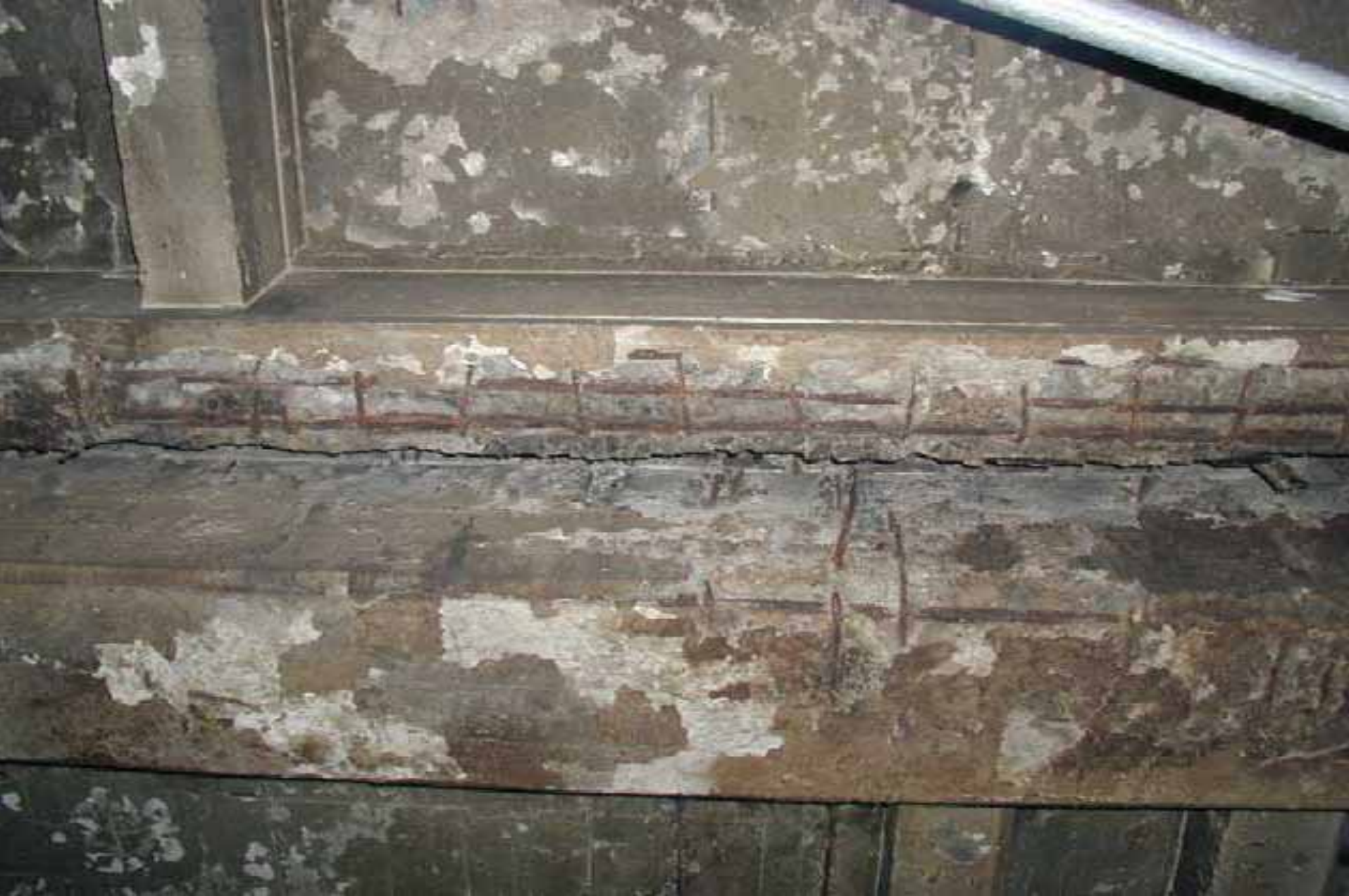
嘉裕关一结构梁腐蚀破坏
