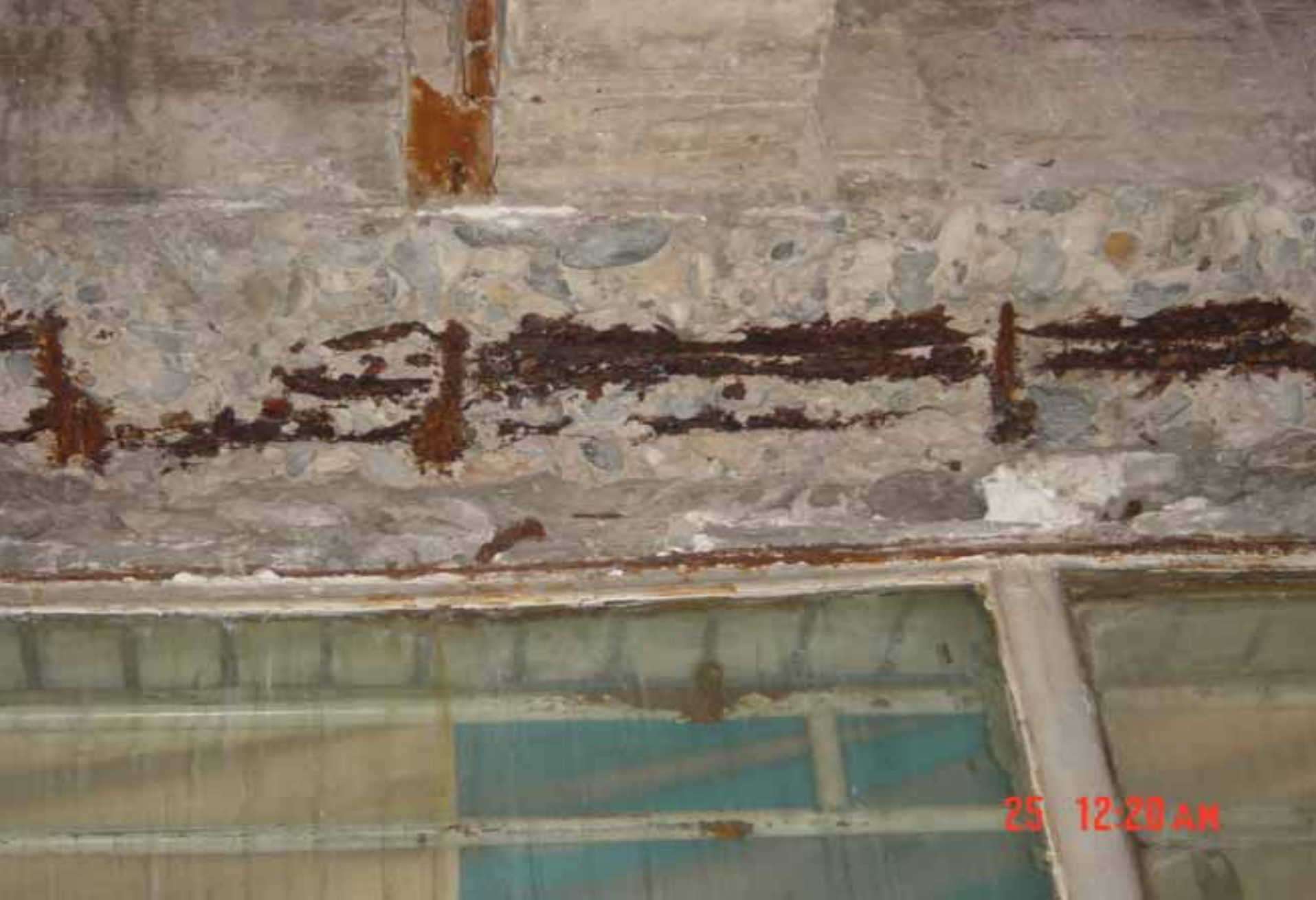
美术馆梁钢筋锈蚀情况
