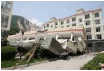
(a) 映秀镇漩口中学坍塌的 5 层教学楼
