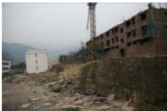
图 16 漩口镇的浆砌石挡墙破坏现象
