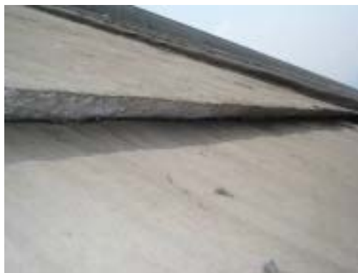
图 18 紫坪铺大坝面板位错现象(四川省紫坪铺开发有限责任公司提供)
