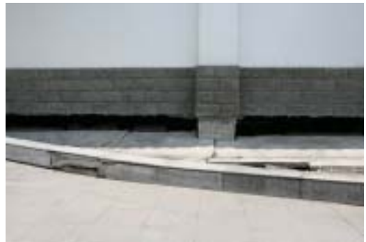
图 9 紫坪铺水利工程副厂房大楼的地基沉降
