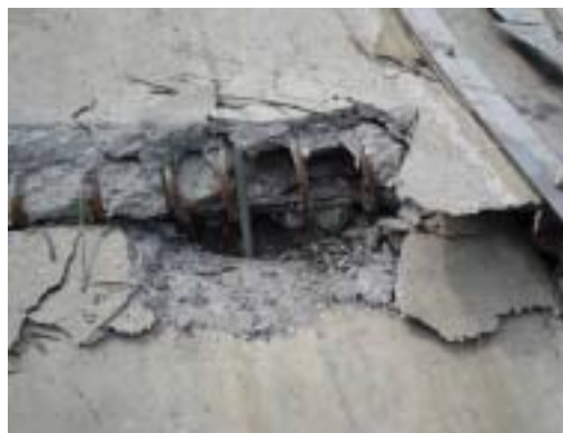
图 19 紫坪铺大坝面板开裂现象(四川省紫坪铺开发有限责任公司提供)
