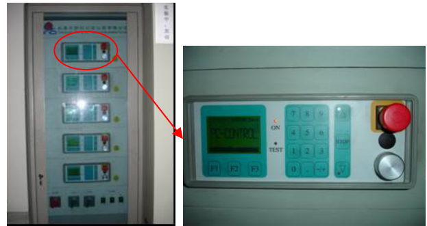
图 10 控制柜及控制器 EDC Fig.10 Control cabinet and controller EDC
