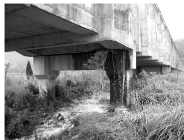
图6 水渠伸缩缝大量漏水
