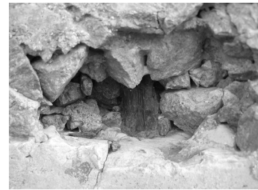
图 3 桥墩混凝土出现孔洞 Fig 3 Holes in Concrete Piers
