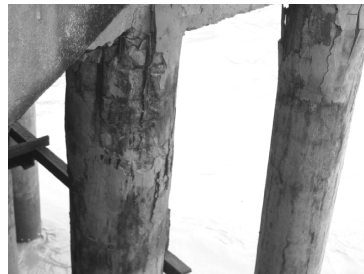
图 11 桩混凝土开裂、锈斑 Fig 11 Pile Concrete Cracking, Rusty
