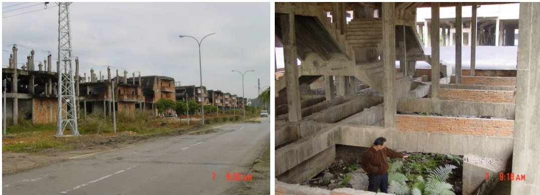
图8 软基沉降导致中山市横门上百栋楼房被迫中途停工
