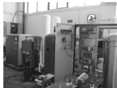
图 12 臭氧发生器系统装置实物图
