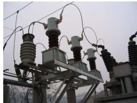
图 3 运行于 35kV 开关站的自适应光学电流互感器 Fig. 3 Adaptive optical current transducer in 35kV station
