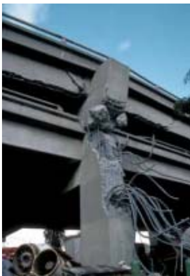
图 9 倒塌后的高架桥
