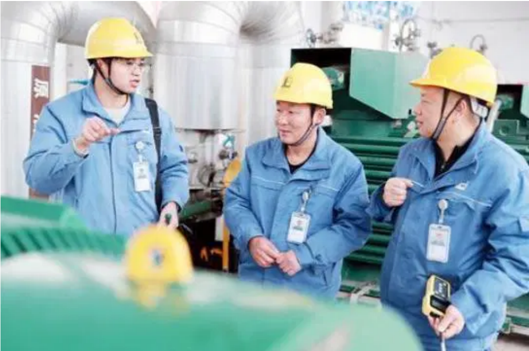
今年以来，湖南石化深入开展“绿色装置”创建工作，积极打造可视化管理样板，持续提升设备管理水平，定期开展设备检验与隐患治理，全力提升设备运行质效。图为装置管理人员检查设备运行情况。
