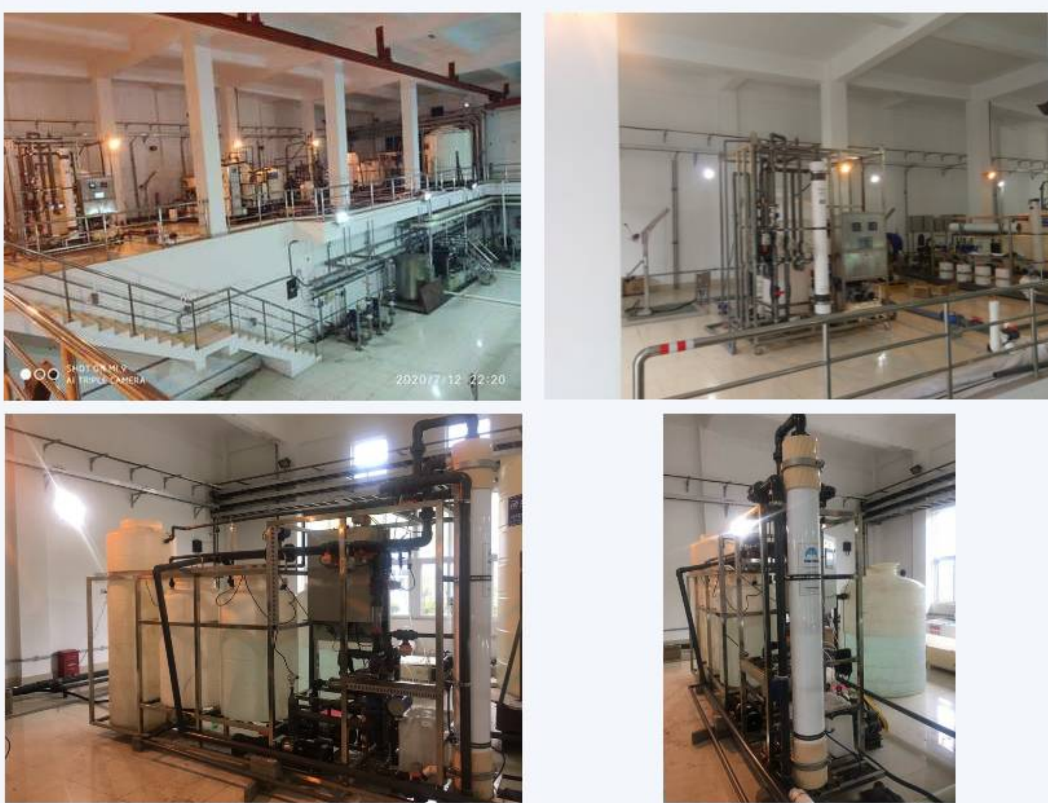
上海市罗泾水厂生产废水中试规模试验（10 m 3 /h）
