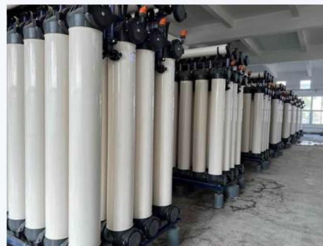
上海市罗泾水厂超滤膜废水回用处理（水量5万m 3 /d）
