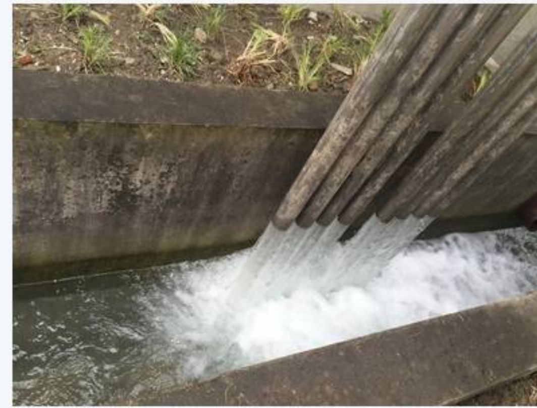
上海市徐泾水厂排泥水回用（水量2000 m 3 /h）
