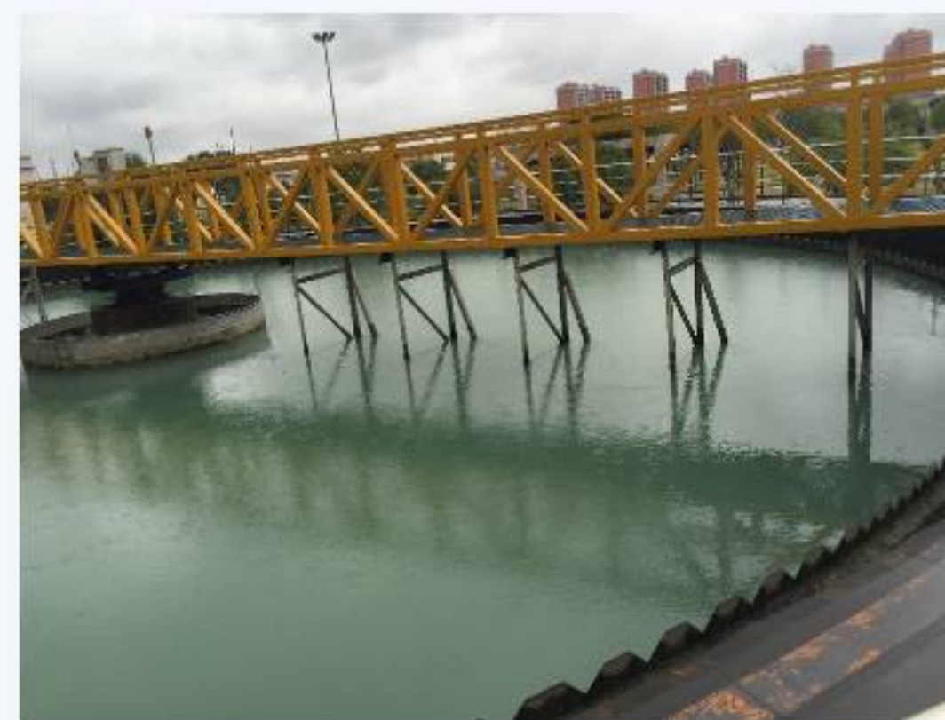
上海市泰和水厂预浓缩池废水回用（回用水量10000 m 3 /d）
