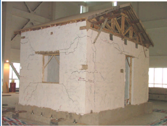
实验结束后，模型房屋墙体裂缝分布情况
