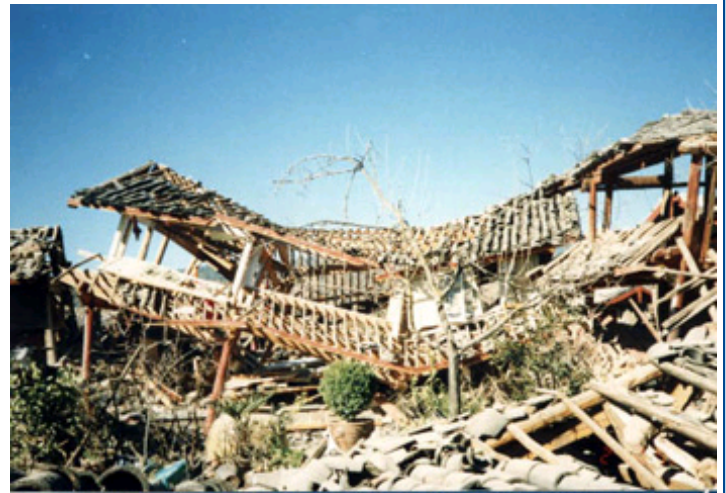
云南丽江地震木构架生土围护墙倒塌
