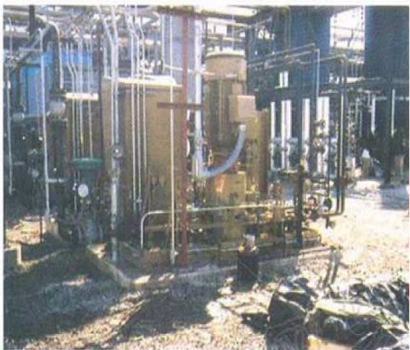
在一个氢循环装置使用的 LMC-331P 型压缩机，包括喘振控制系统，罐式隔音罩，控制盘和外置润滑油系统全部安装在公用底板上
