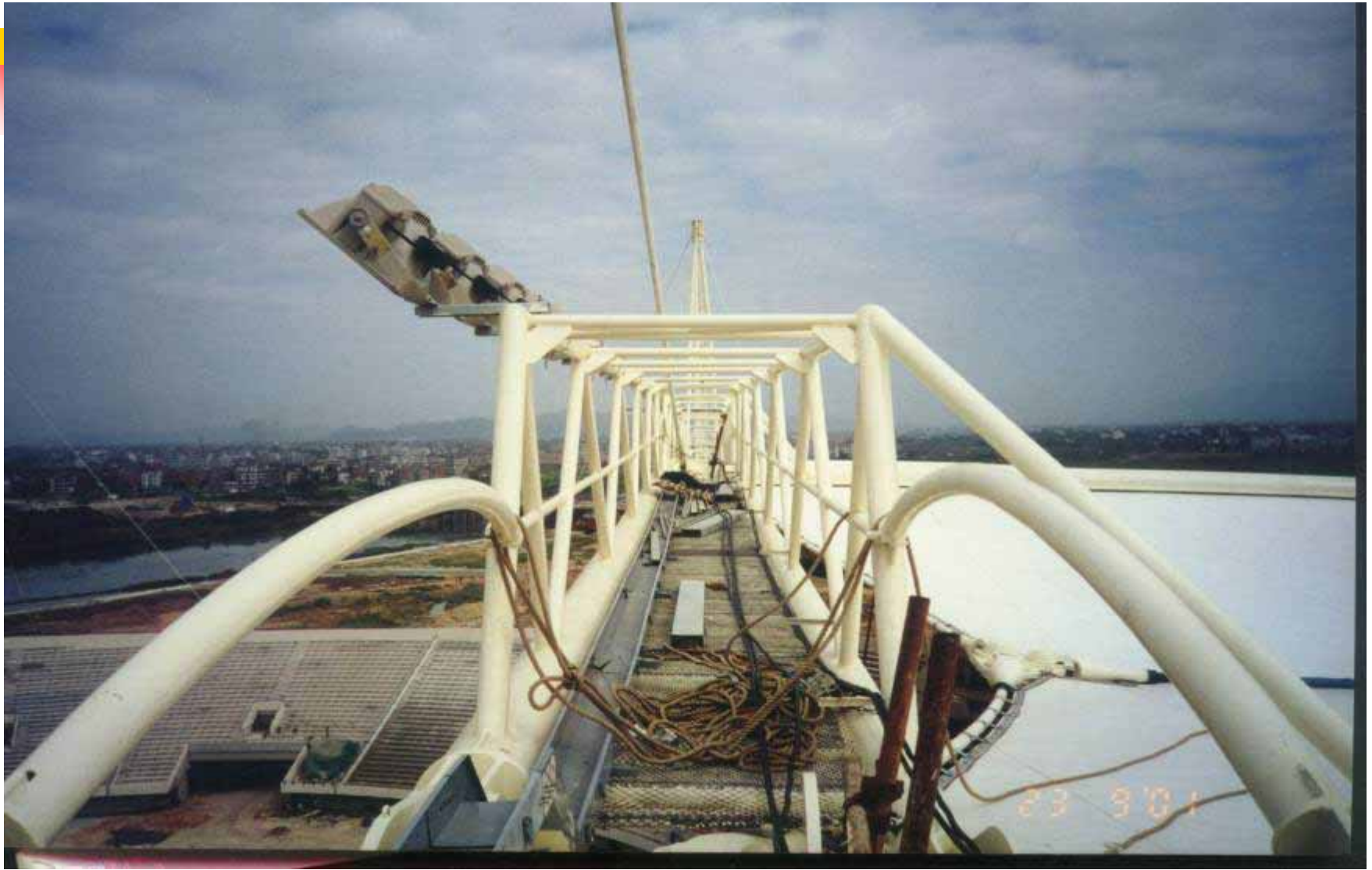
■钢马道，马道上装有灯光照明。
