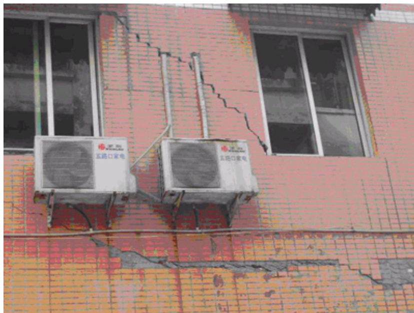
图1 江油市某楼窗间墙破坏
