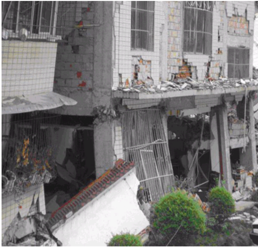
图3 北川县城某楼梁和柱的破坏
