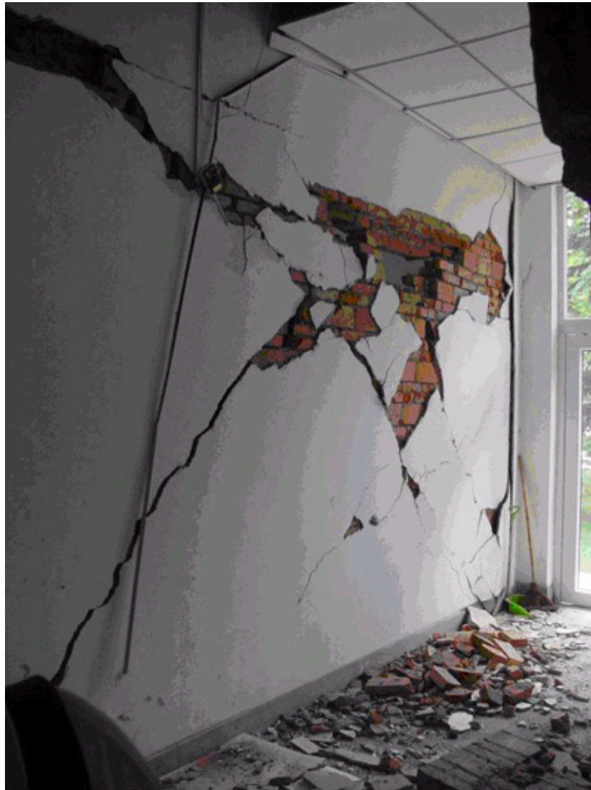
图2 西南科技大学科某楼底层填充墙破坏
