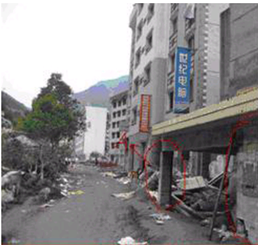
图5 北川某底框结构房屋柱顶节点破坏
