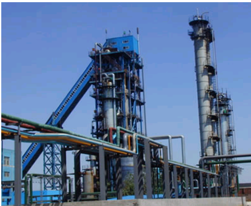
加压灰熔聚流化床粉煤气化工业示范装置
