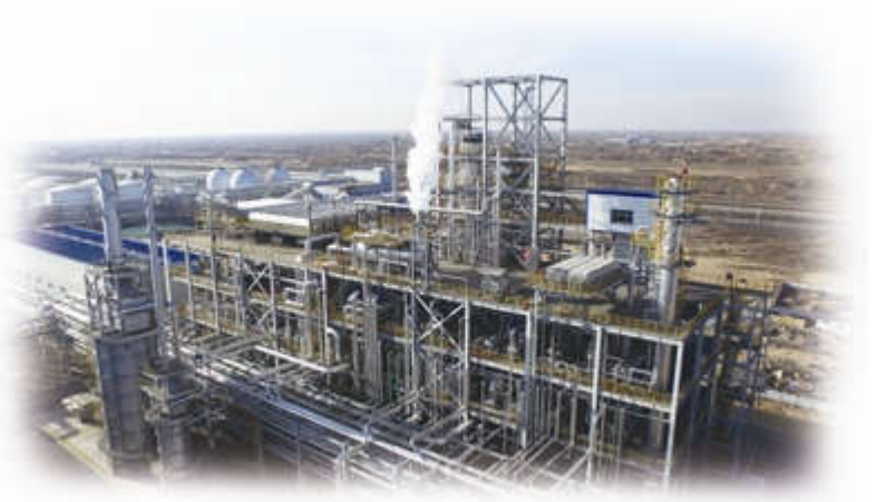
充矿未来能源10万吨/年高温费托合成工业示范装置
