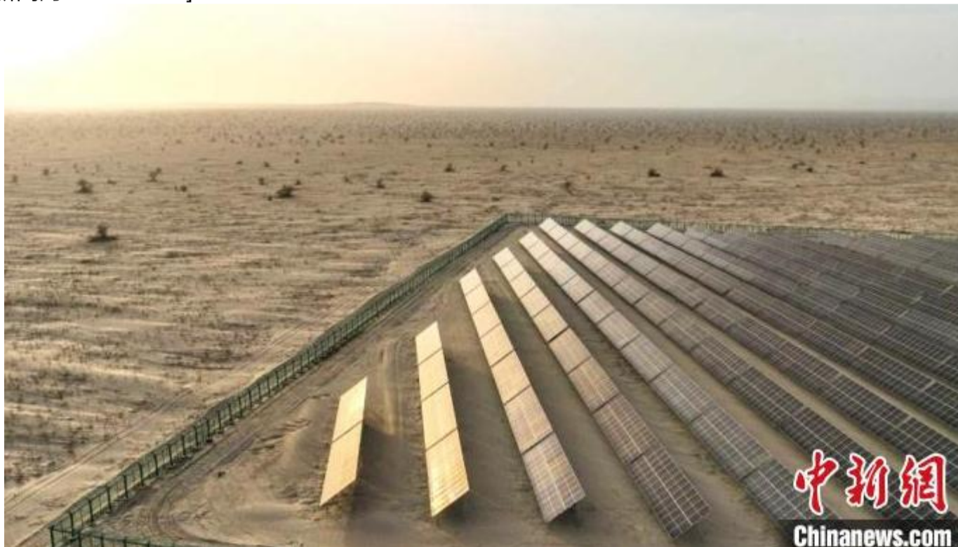
塔里木油田和田河气田开发调整地面工程3.6兆瓦光伏电站。
