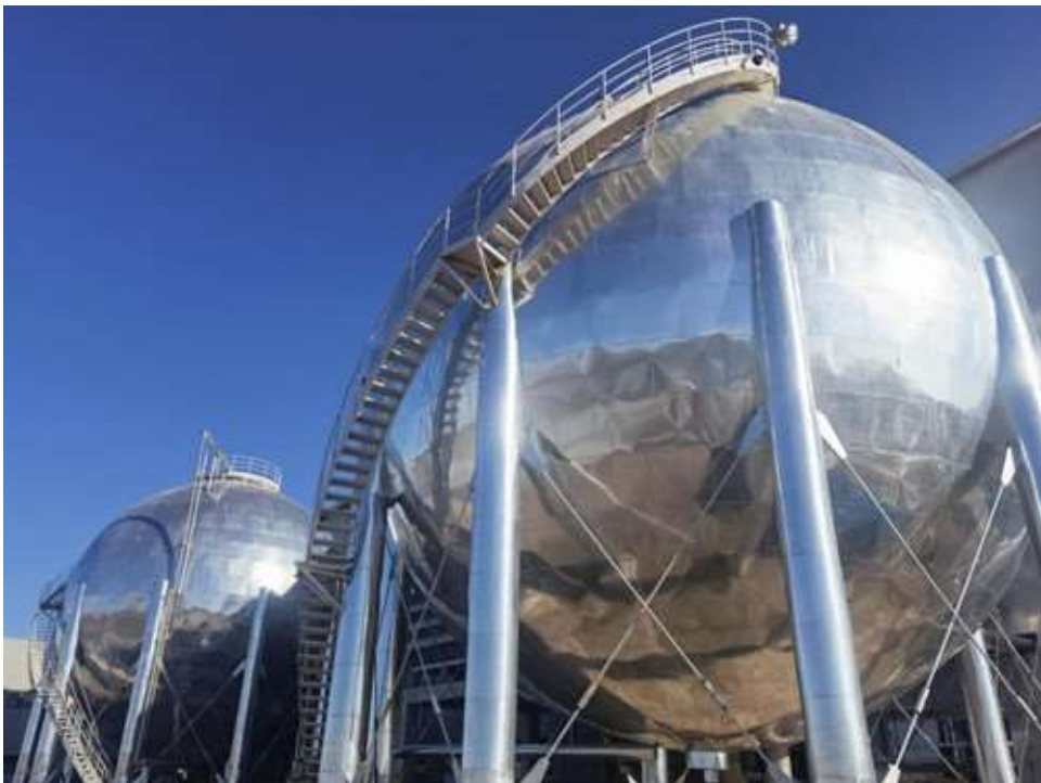
图2 百兆瓦先进压缩空气储能国家示范项目储热罐
