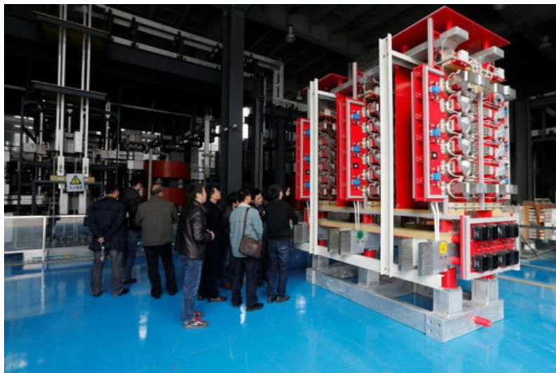
参观ITER电源测试大厅
