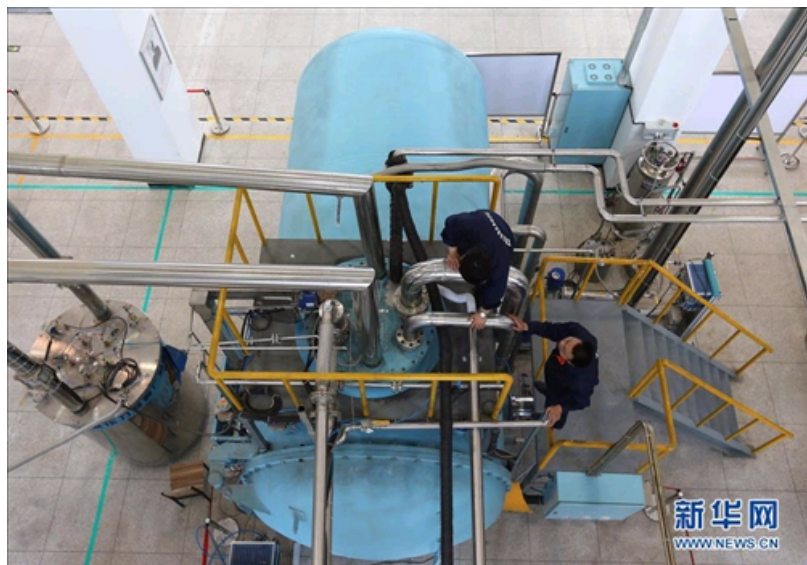
工作人员在检测设备运行情况
