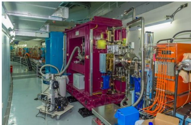
安装在储存环中的锆铁硼低温永磁波荡器
