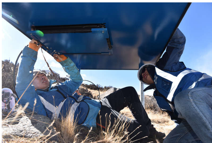
探测器组装检测现场（海子山观测基地）
