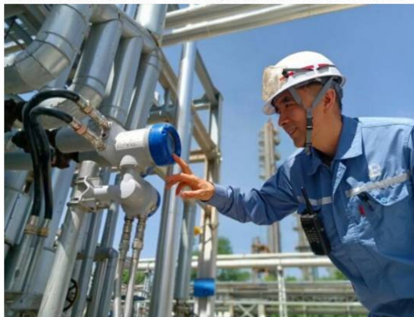
图为燕山石化乙烯装置新区单元班组长在现场查看黄油减排装置流量情况。霍思雨 摄
