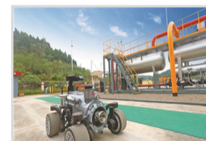
智能巡检 质效双升
