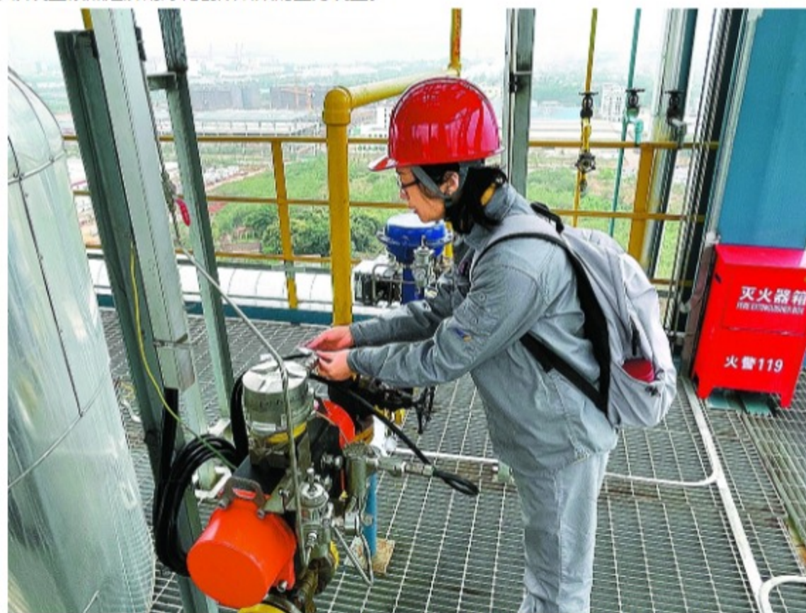
SEI专家在海南炼化260万吨/年逆流连续重整装置反再框架做开工前检查。
