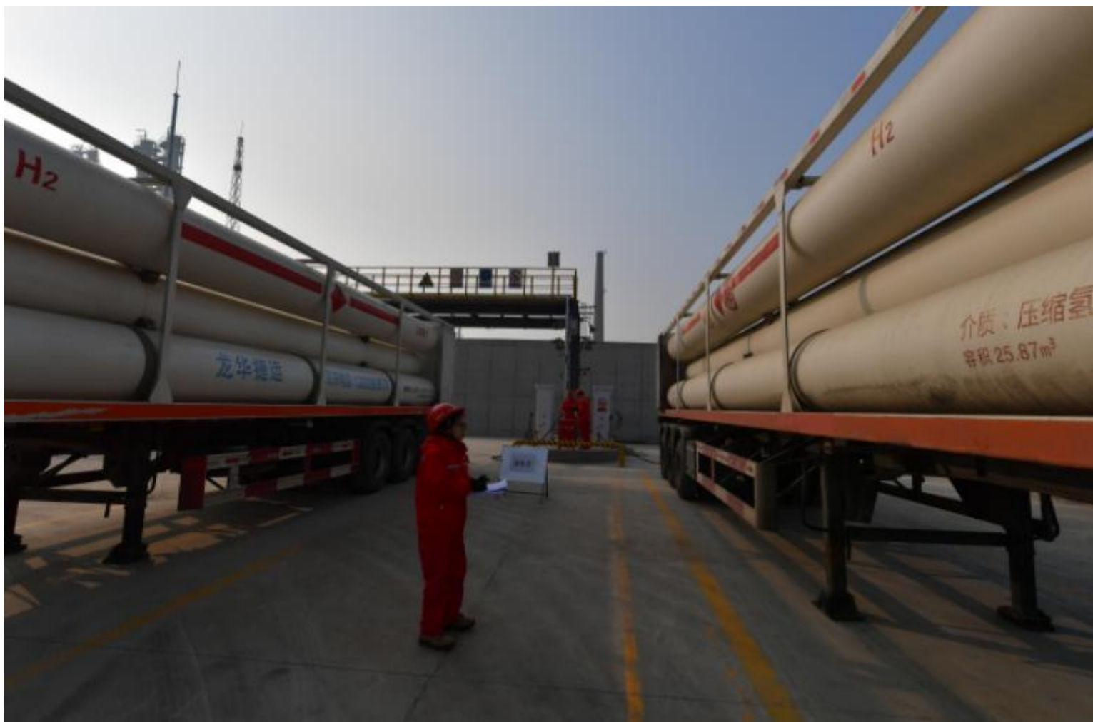
图为工作人员在加氢母站确认加氢气数量。
