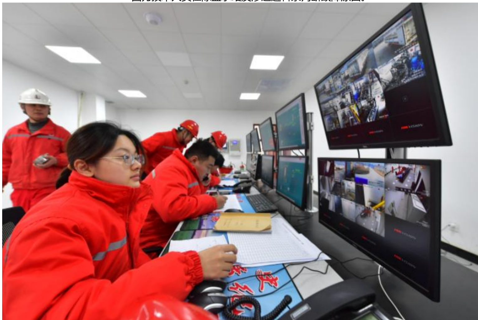
图为工作人员在机柜间监控装置运行参数。
