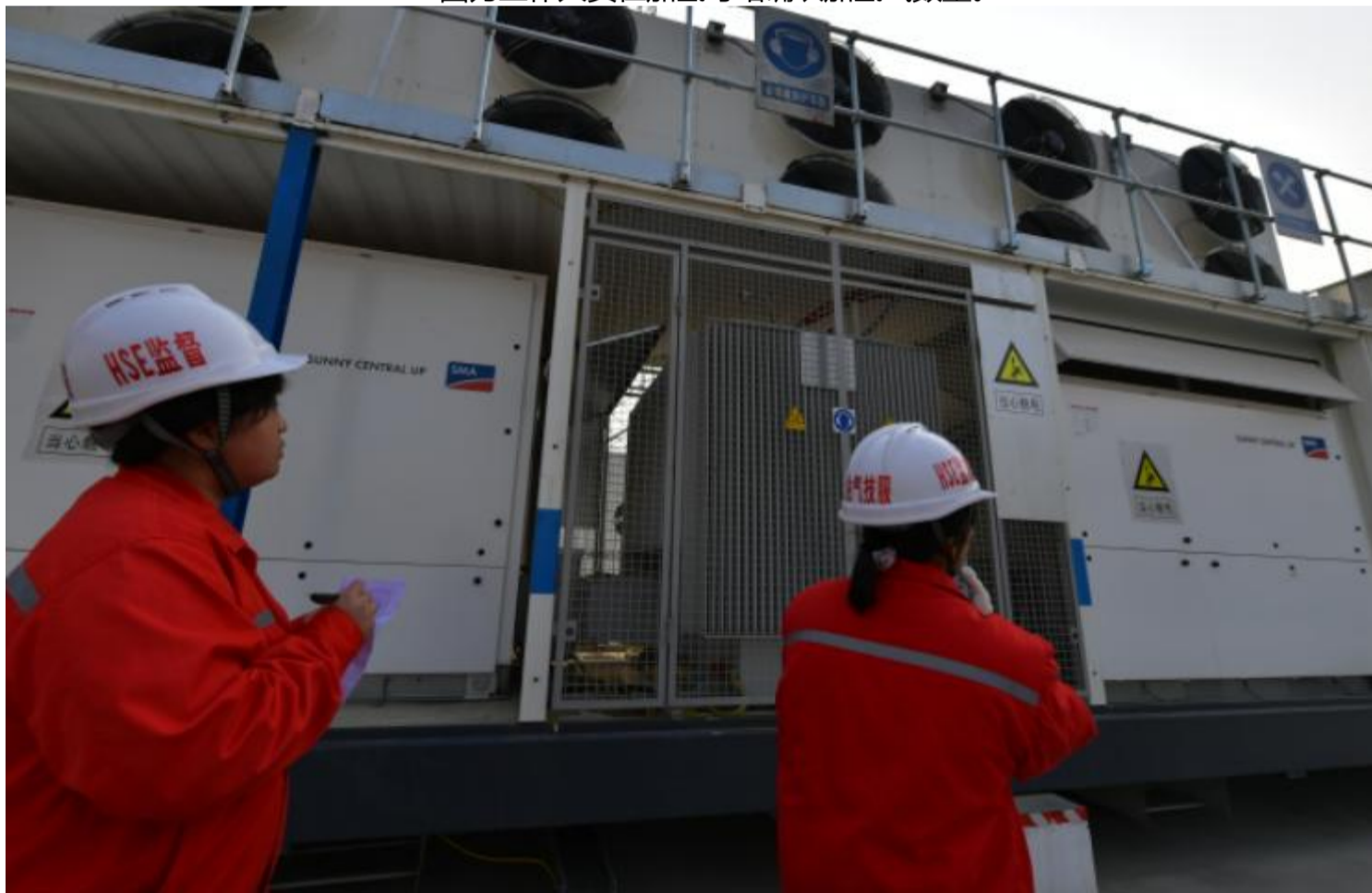
图为安全管理人员进行PEM制氢电源柜及空冷系统噪音测试。
