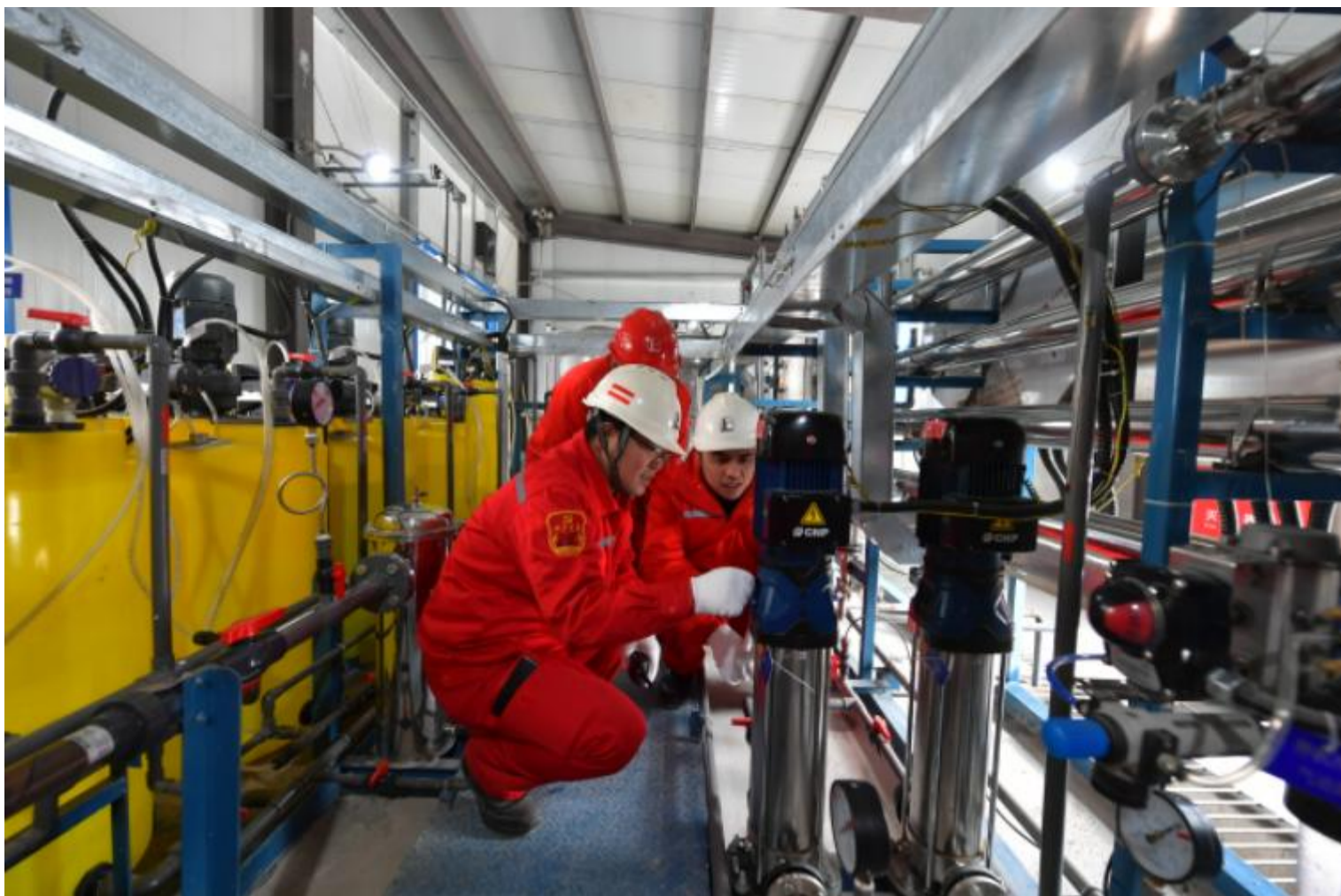
图为技术人员在除盐车站反渗透进料泵判断故障原因。
