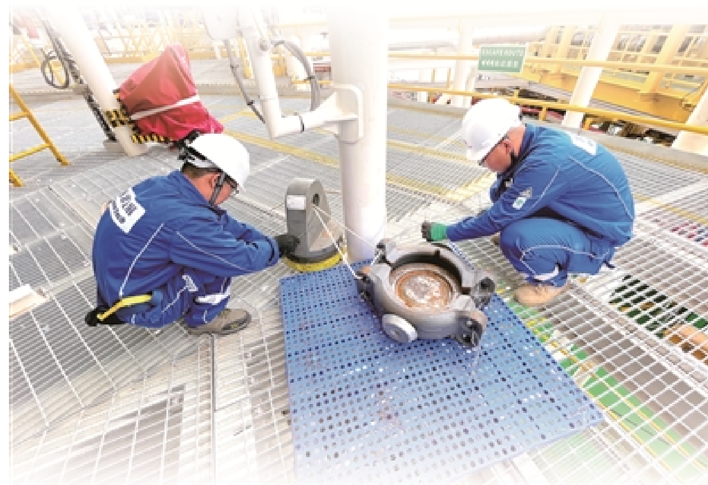
图③：工作人员正在“海洋石油123” FPSO上开展单点吊具固定作业，以应对台风“泰利”。
