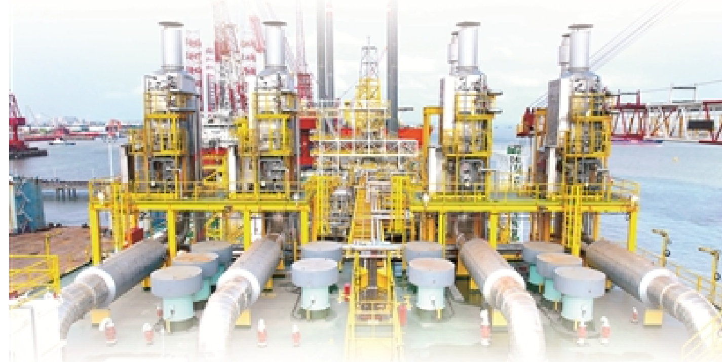
图①：“海洋石油123” FPSO生产工艺模块。
