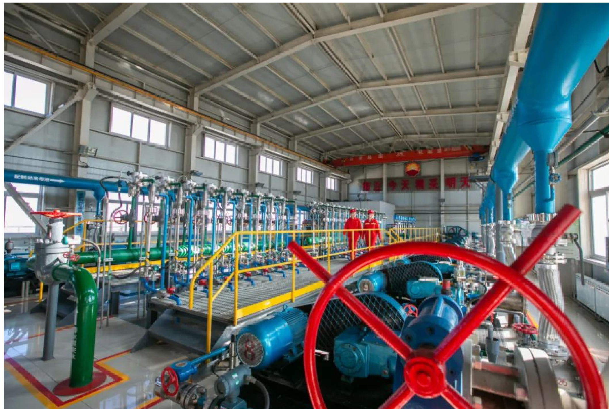
辽河油田员工在锦16块聚表复合驱注入站巡检。孙洪洲 摄
