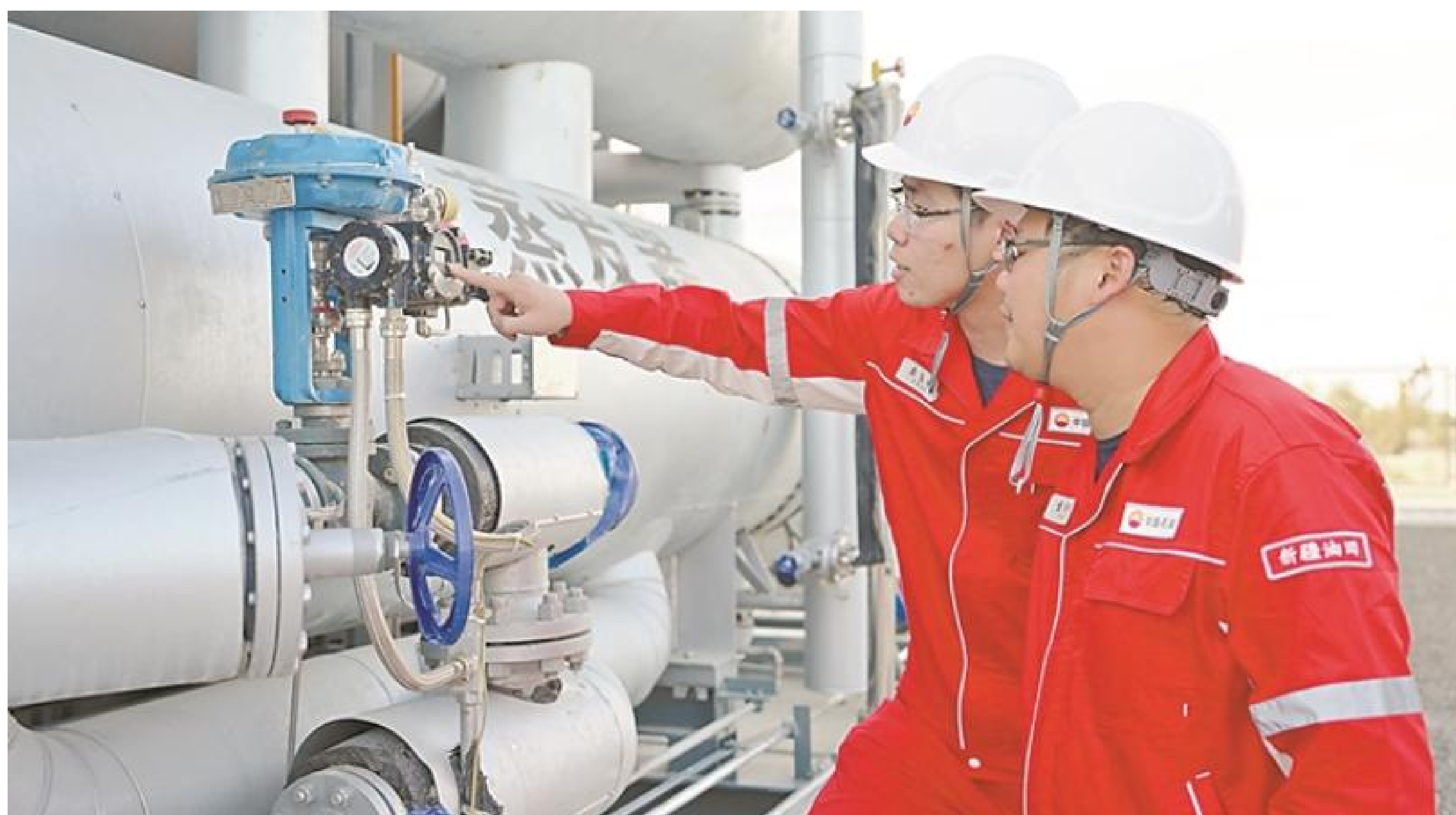
员工检查八区530井区的设备运行情况。
