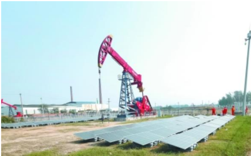
中原油田建成的首个可移动光伏电站亮相井场。
