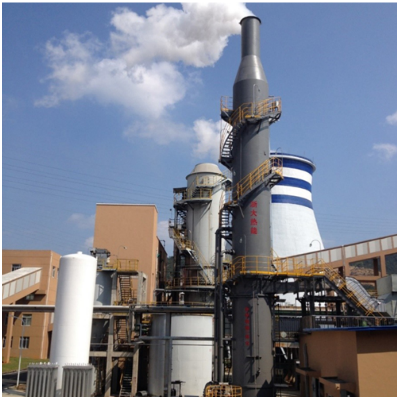
杭州中策清泉活性分子污染物一体化脱除塔外景
