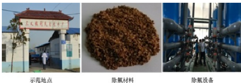
图2 安徽省蒙城县三义镇利民水厂纳米饮用水除氟工程
