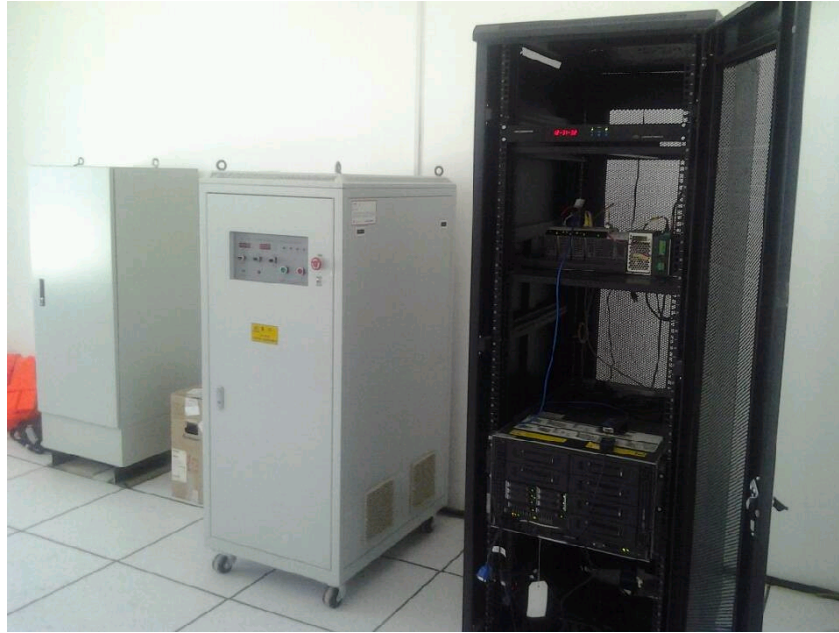
岸站电源及控制系统
