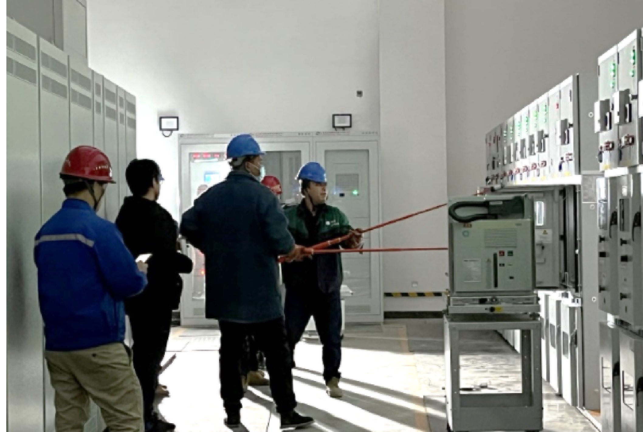
图1. 10kV高压柜不同母线核相
