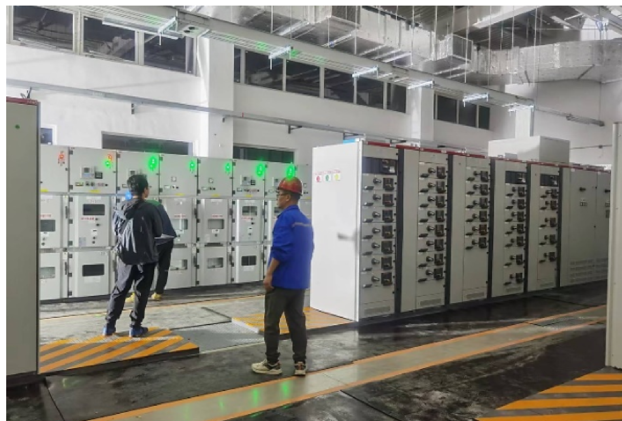
图2. 环2配电室发电中
