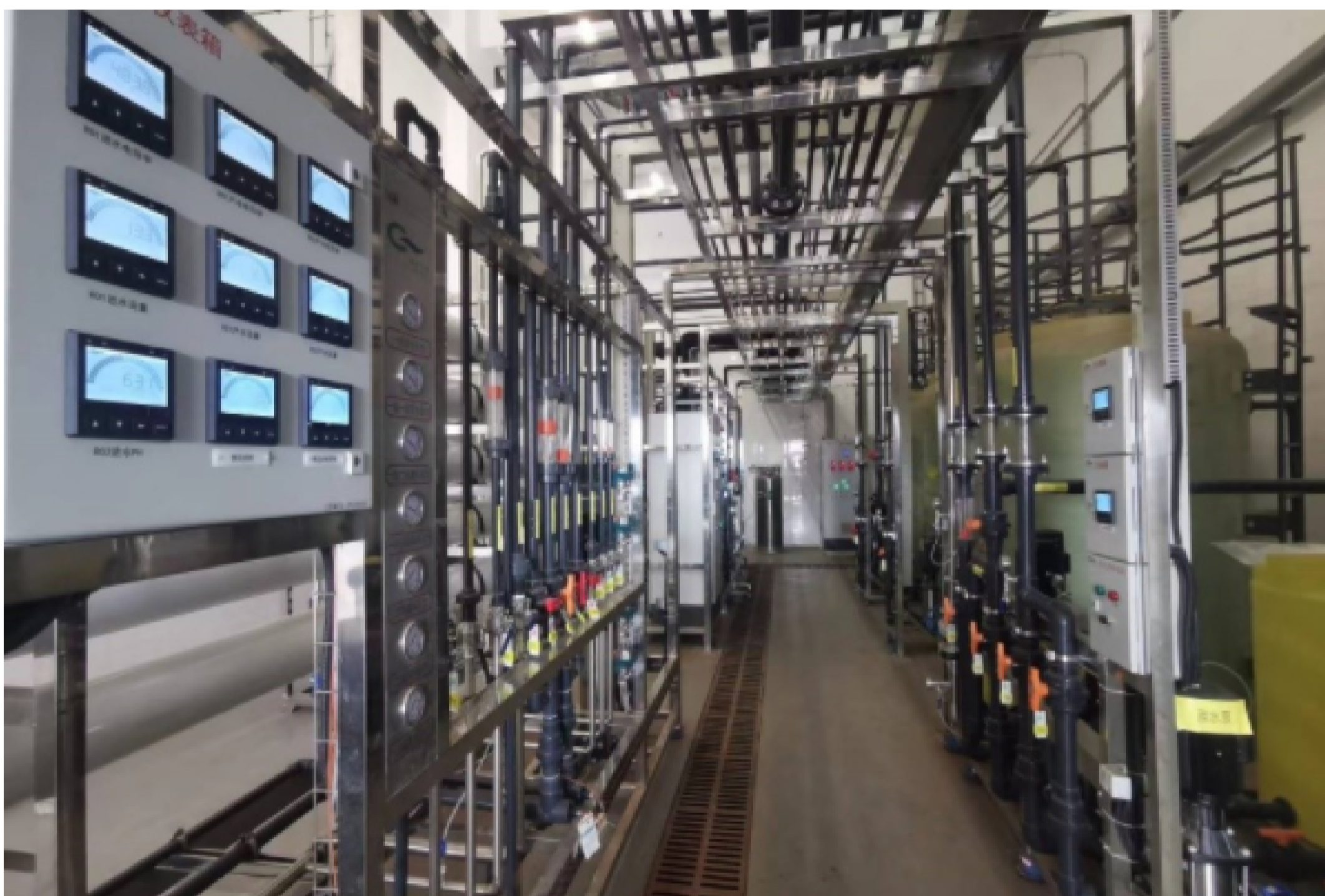
纯水、软化水设备现场照片
