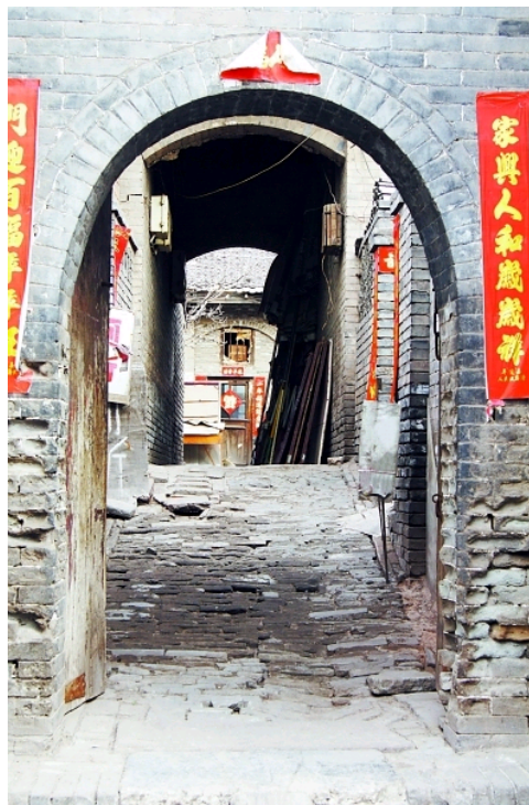
墙皮已大量剥落的民居 光明日报记者 李韵摄
