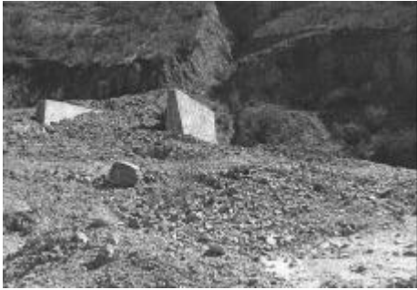
图 1 海竹段某处泥石流使原防护设施失效
